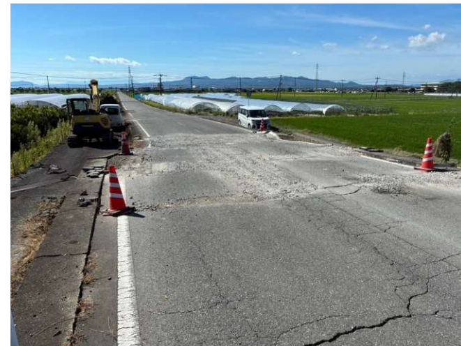
町道の変状と応急処置状況
